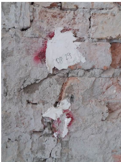
Gipszpogácsa – Túrisztikai lépcsőház felsőszintjein a függőleges repedése
