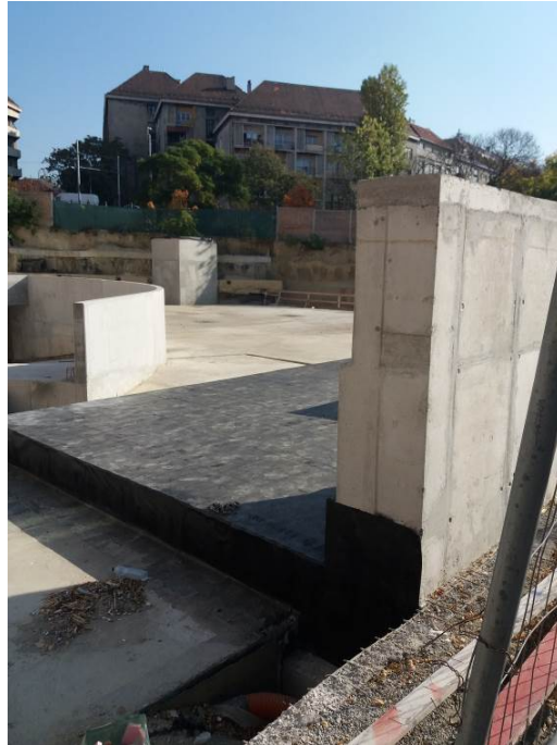
Mélygarázsba helyezett közcélú trafóház vízszigetelése
